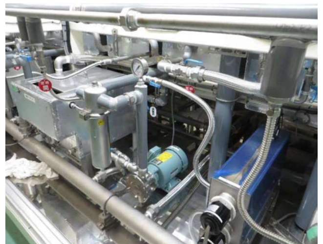
サブタンク・配管
